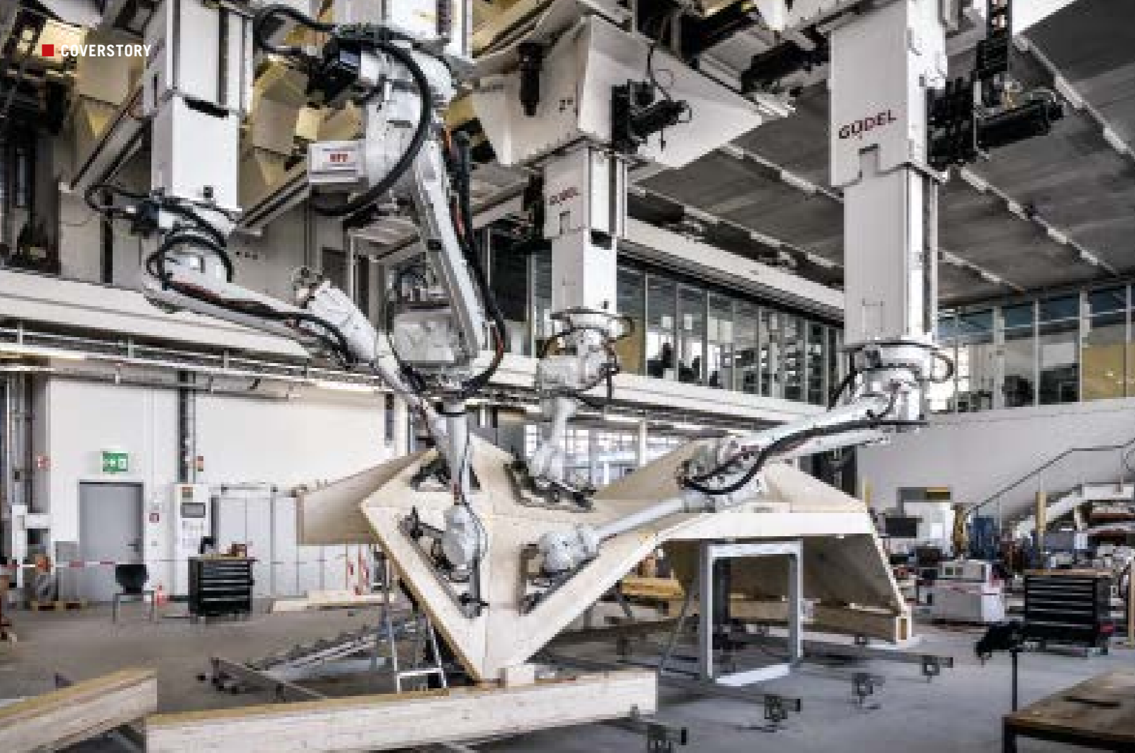
Vier Roboterarme fügen die dreieckigen BSP-Platten millimetergenau aneinander. Anschließend werden die Elemente mit Gießharz von Handwerkern verleimt
