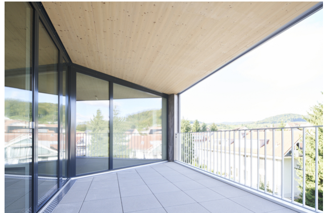
Wärmebrücken einfach gemacht. Die CLT-Decke läuft von der Wohnung zur Loggia einfach durch.
